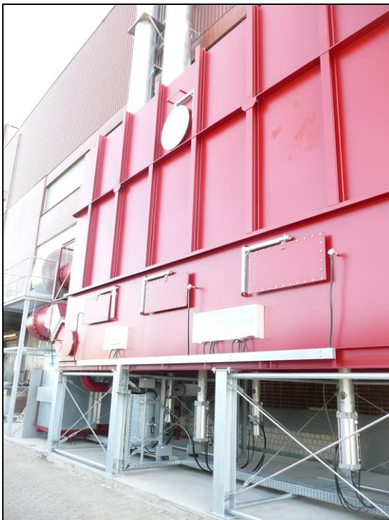
RNV- 3 Kammer Anlage mit keramischer Speichermasse
