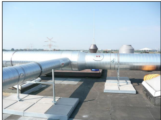
Zusammenführung diverser Abluftleitungen
